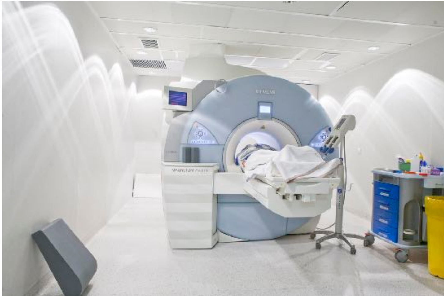
Sala de RM acDI Hospital de Dénia
